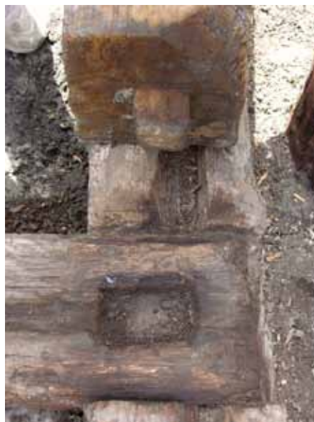
Ryc. 106. Słup północno-zachodniego narożnika jatki 16 i 17 z II szeregu w III poziomie osadniczym w trakcie demontażu. Łączenie za pomocą gniazda w belce przyciesiowej i czopa w spodniej części słupa. Widok od północy. Fot. R. Janczukowicz
