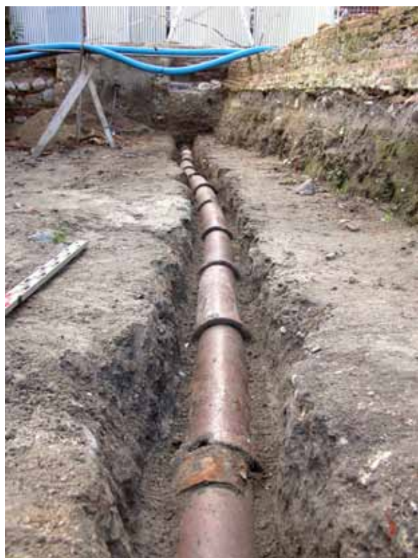
Ryc. 161. Południowy odcinek systemu kamionkowych rur kanalizacyjnych na zapleczu kamienicy przy ul. Św. Ducha 43. Widok od północy. Fot. R. Krzywdziński
