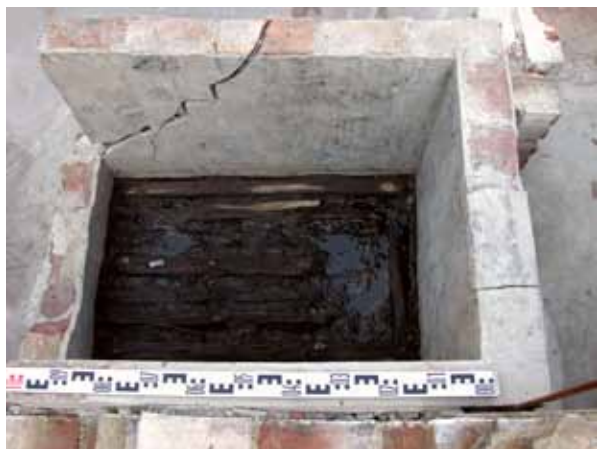
Ryc. 169. Pozostałości murowanego zbiornika w południowej części zachodniego traktu piwnicy (pomieszczenie 18) kamienicy przy ul. Św. Ducha 43. Widok od zachodu. Fot. R. Krzywdziński
