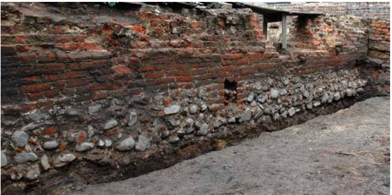
Ryc. 17. Św. Ducha 45/46. Lico W ściany sąsiedzkiej gotyckiej kamienicy – część centralna. Widoczna wnęka. Część górna przebudowana w XVII wieku. Widok od W
